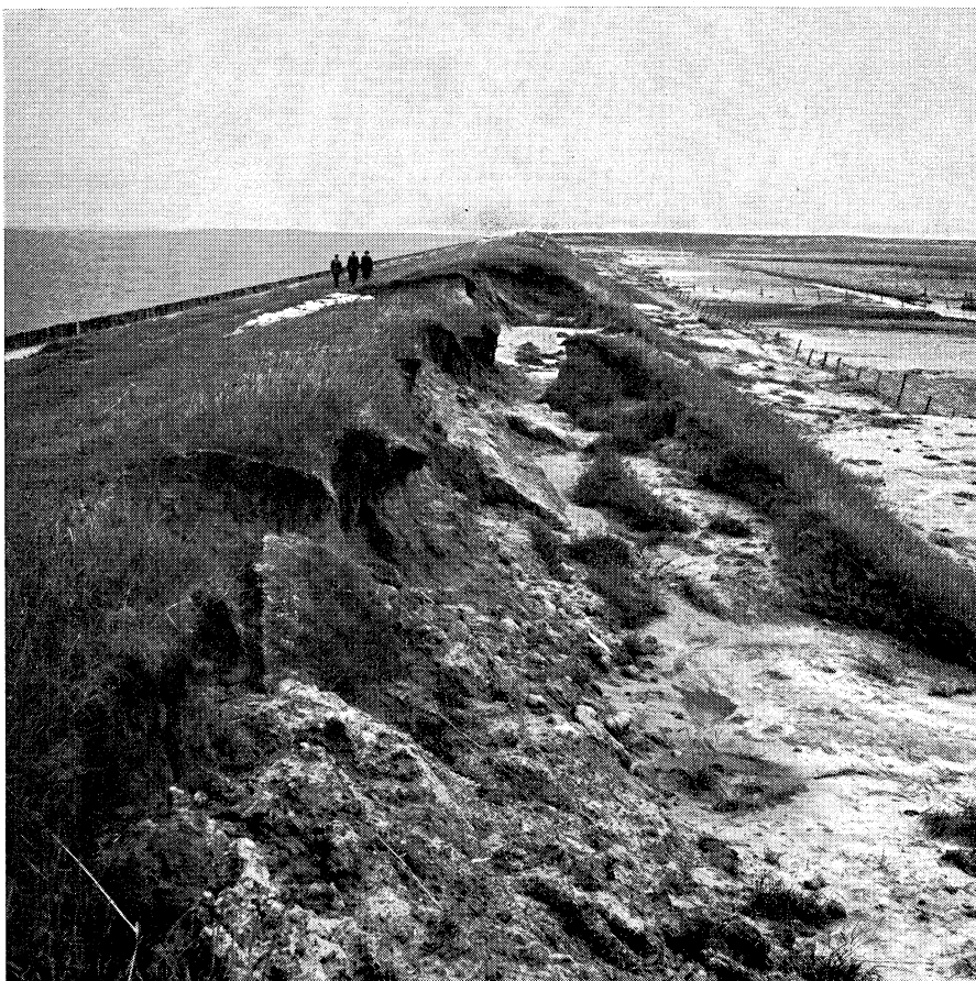
Dijk met aangetast binnenbeloop
